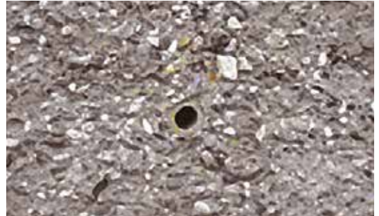
Fig. 1 Risultato dell'elemento in calcestruzzo dopo la prova di resistenza al fuoco.
