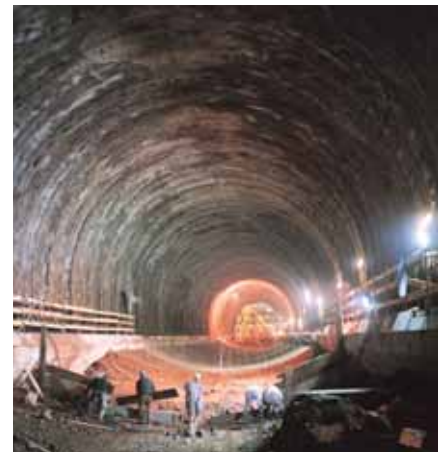
Pre-rivestimento in galleria mediante spritz beton con Ruredil X Fiber 54S senza uso di reti metalliche.
